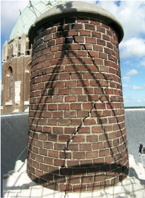
Bovenstuk van de gescheurde schoorsteen.
