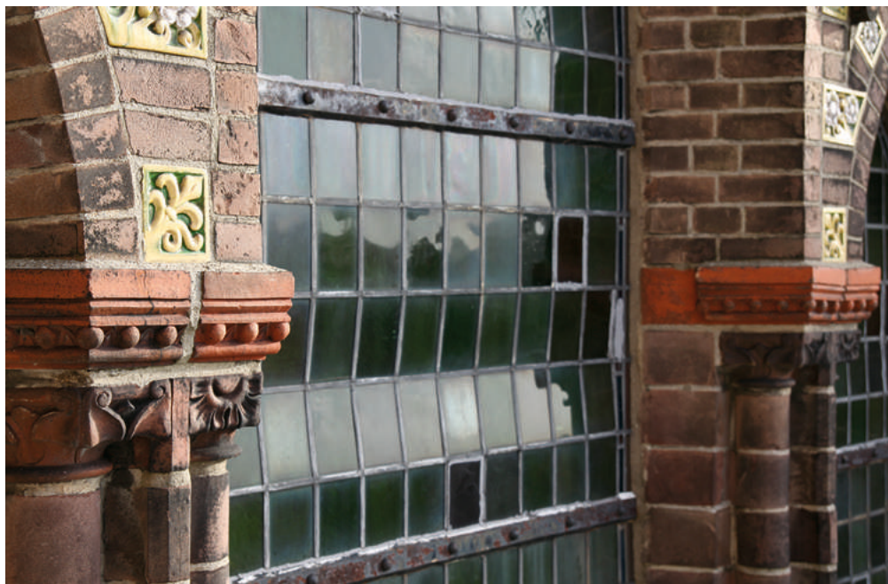
De slechte toestand van de glas-in-loodramen inclusief de brugstaven.
